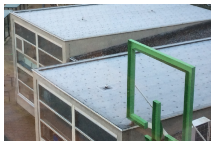
figuur 6-3 Het gevolg van het aanbrengen van bevestigingsmiddelen: doorbreking van de thermische isolatie (dus extra warmteverlies)
