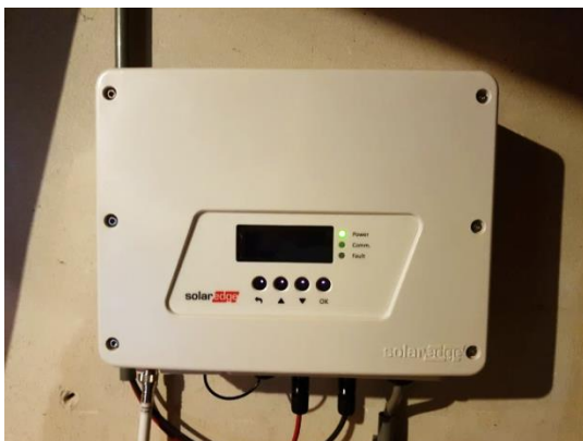
Figuur 10. Omvormer in een woning
