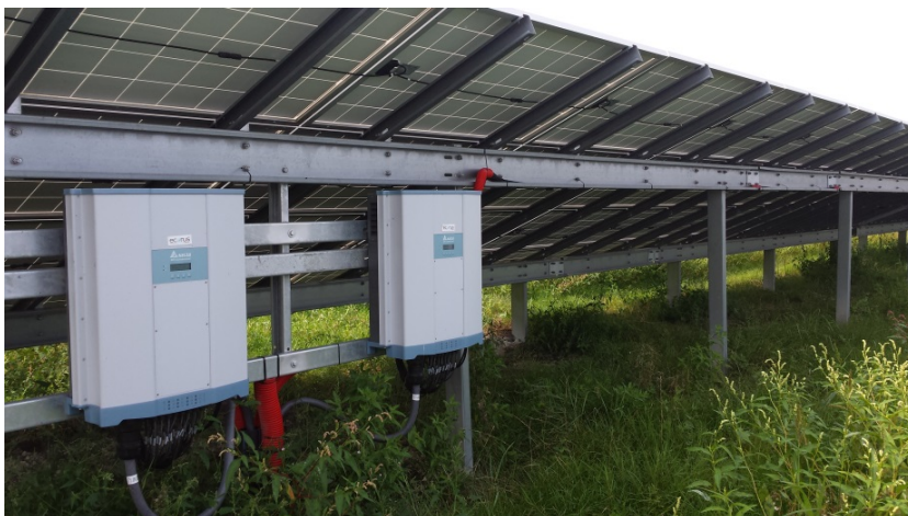
Figuur 12. Twee omvormers in een zonnepark
