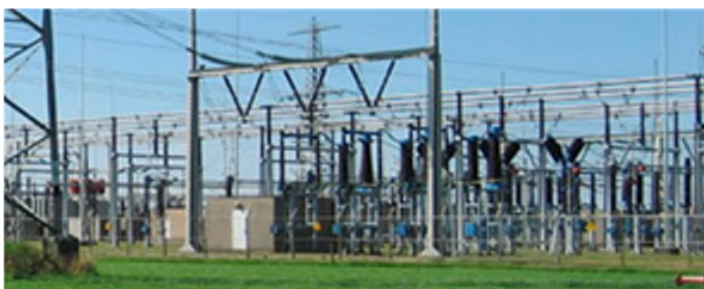
Figuur 2.2 Voorbeeld van hoogspanningsstation
